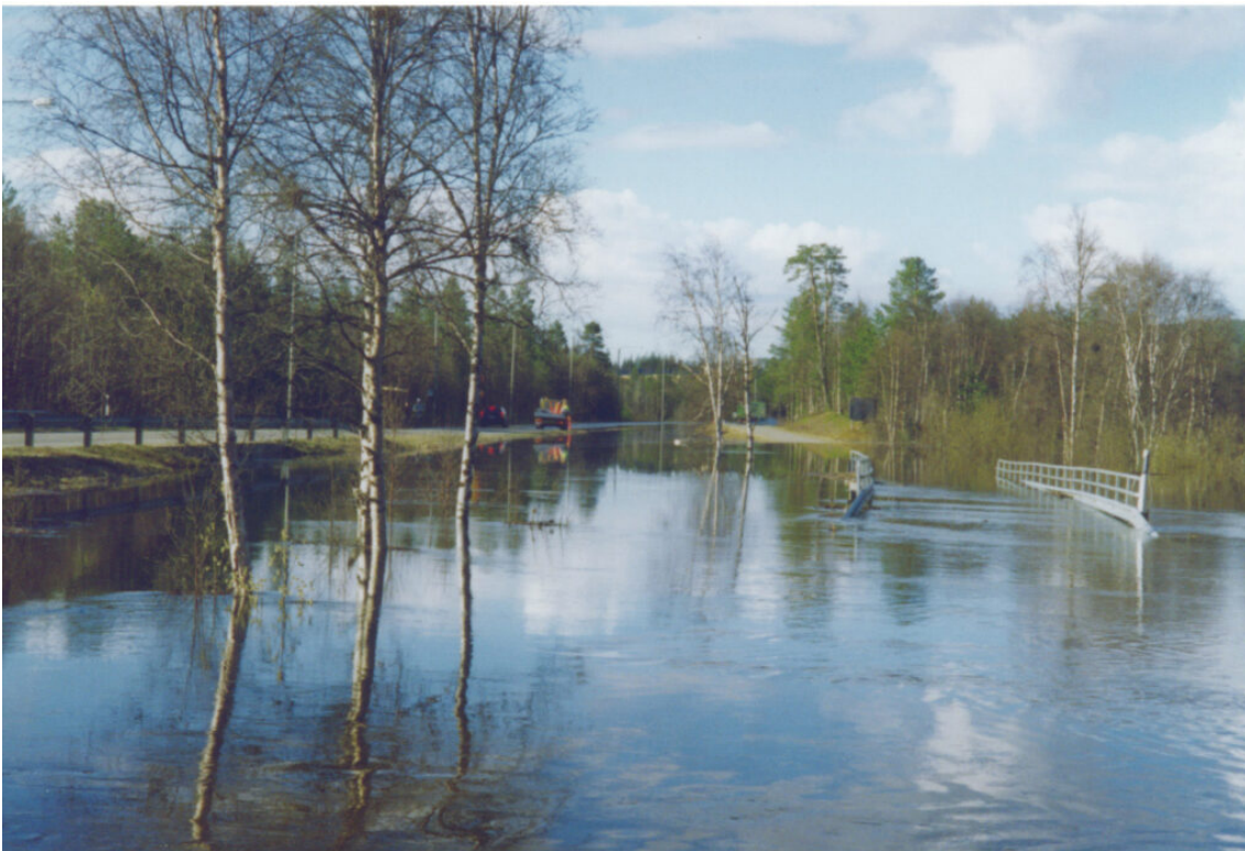
Ivalon Kerttuojan pyörätie tulvaveden peitossa vuoden 2005 tulvassa (kuva: Lapin ELY-keskus).
